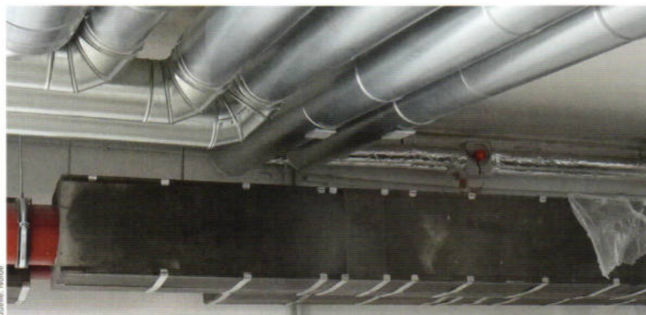
3 – Außenansicht des gedämmten Rohrwärmetauschers AWT 2 als SML-Rohr mit ummanteltem Wärmetauscher
