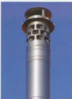
1 Mündungsabschluss mit Windkat
