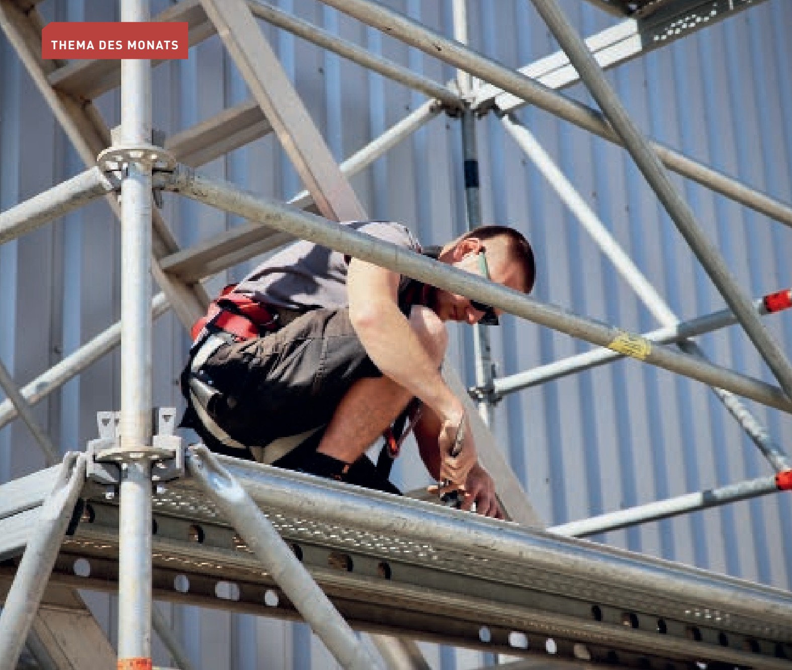
▲ Sämtliche Gerüstbauarbeiten waren pünktlich zum vereinbarten Termin abgeschlossen, sodass die PV-Anlage wie geplant installiert werden konnte
