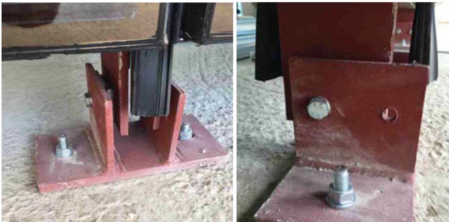
Fig. 19 - Errori nella posa in opera degli ancoraggi di facciata: staffe al piede
