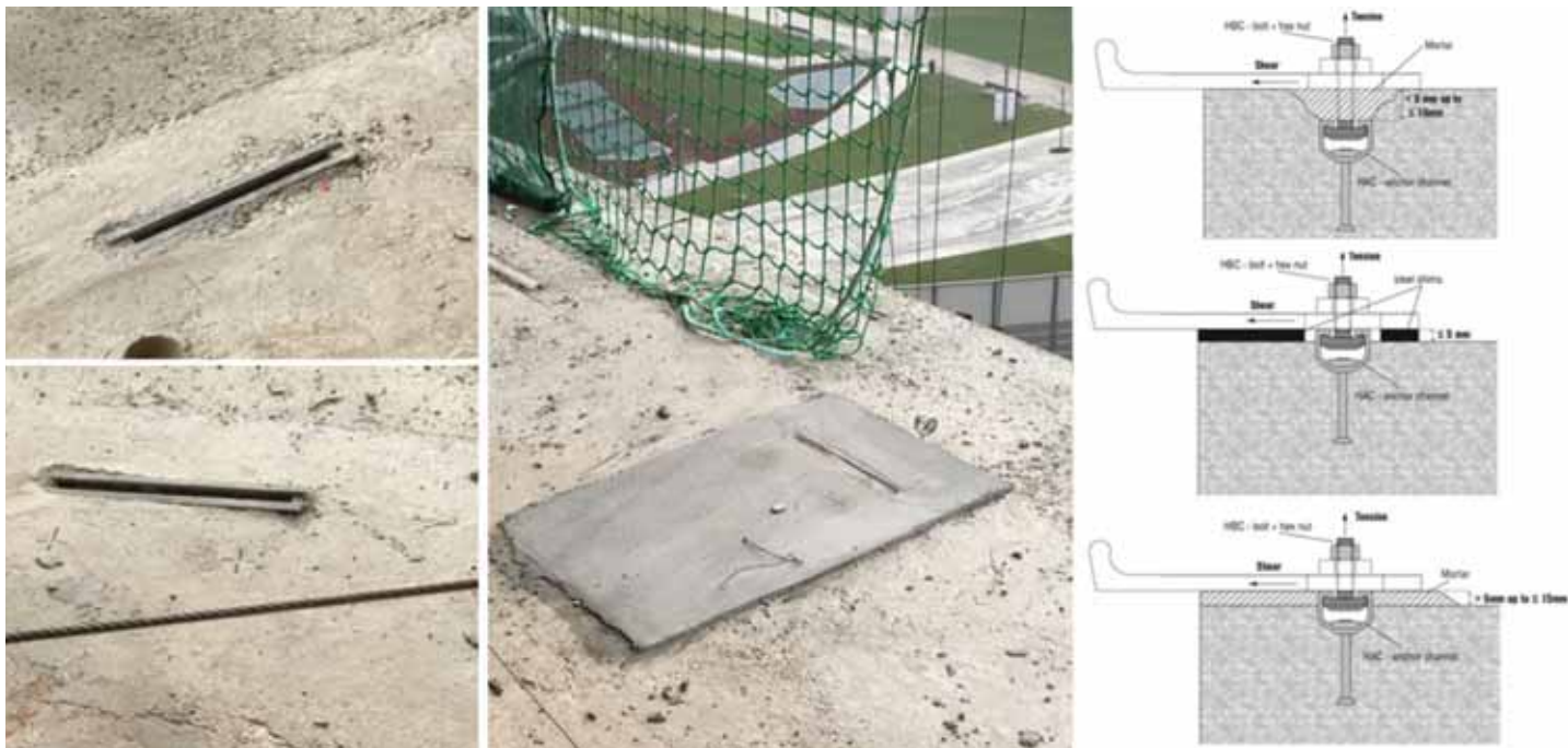
Fig. 18 - Sistemi di ancoraggio annegati nel getto: esempio di errori di posa e tolleranze di di ripristino ( remedial work )
