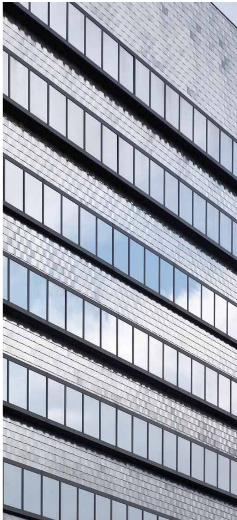
Fig. 4 -Dettaglio della facciata ventilata, lato est. Sono ben visibili le piastrelle in gres porcellanato Snake di 5+1AA e Casalgrande Padana, realizzate sul licenza da Iris Ceramica. Le piastrelle hanno un disegno "diamantato" a farfalla con finitura dorata e sono state posate su una struttura in alluminio che Stahlbau Pichler ha realizzato per minimizzare la fuga
