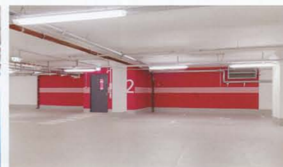
Damit Chloride nicht in den Beton gelangen, muss dieser mit einem Oberflächenschutzsystem versehen werden – bei der Tiefgarage des „Arabeska“ ging es dabei immerhin um rund 9.000 Quadratmeter Fläche.
