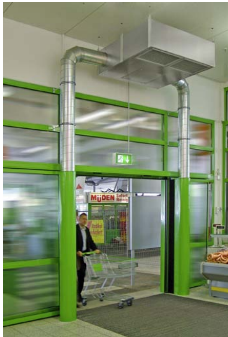
Attraktiv gestaltete Luftwandanlage an einem Marktzugang.
