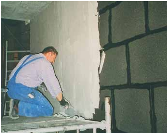
Luftschacht aus nichtbrennbaren Baustoffen: FOAMGLAS® mit Beschichtung PC® 74 A2
