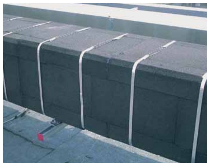
Frischlufkanal mit FOAMGLAS®: verhindert dauerhaft Tauwasser, ist dampfdicht und nichtbrennbar.
