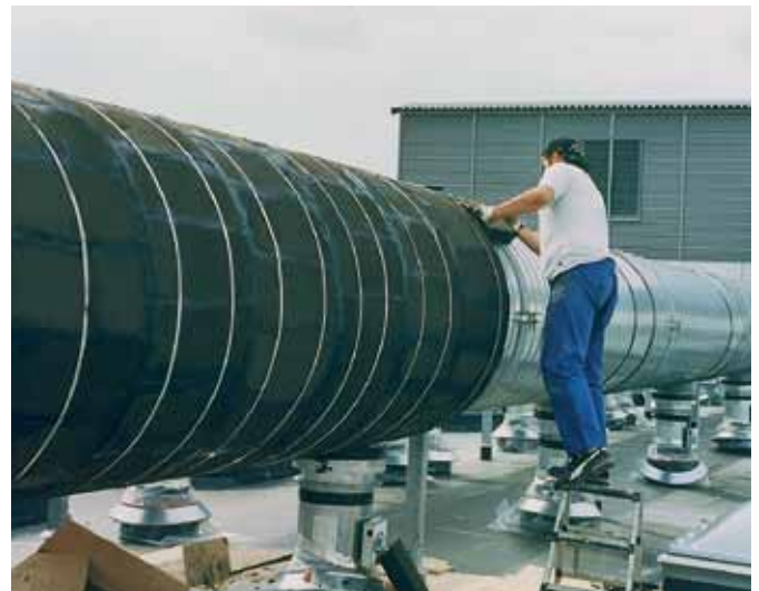
Lüftungskanal mit FOAMGLAS®-Segmenten.
