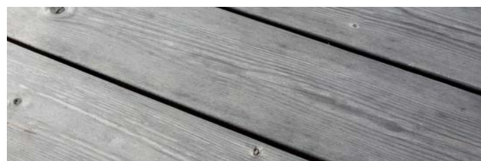
Ungeölte Thermory Benchmark Thermo-Kiefer Terrasse nach einigen Jahren
