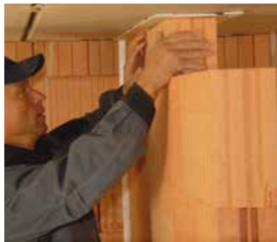
Anschließen des Deckenprofils: Aufmauern der restlichen Ziegellagen und Verschließen der Fuge zur Decke mit Mörtel.
