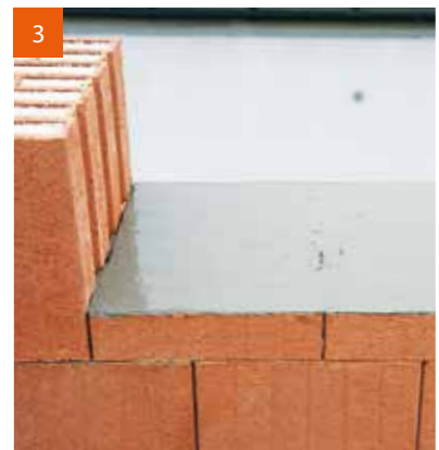
Die Fensterbrüstung wird mit Dünnbettmörtel während der Bauphase vor Regen und Schnee geschützt.
