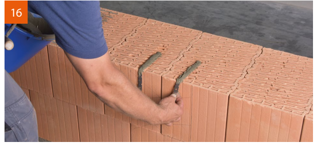
16 Einsetzen der in Dünnbettmörtel eingetauchten Flachstahlanker. Um Verletzungen vorzubeugen, werden die Anker umgebogen eingesetzt.
