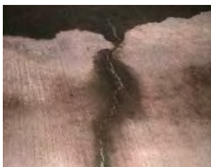
Feuchtschaden im Bauwerk
