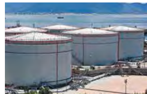
Tanks und Behälter
