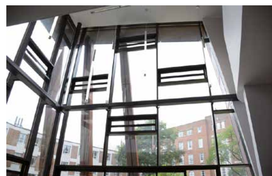
Queens-University Belfast: Montage in Pfosten-Riegel-Konstruktion. Elektrisch betrieben mit D+H Antriebern Typ LDF 100/70
