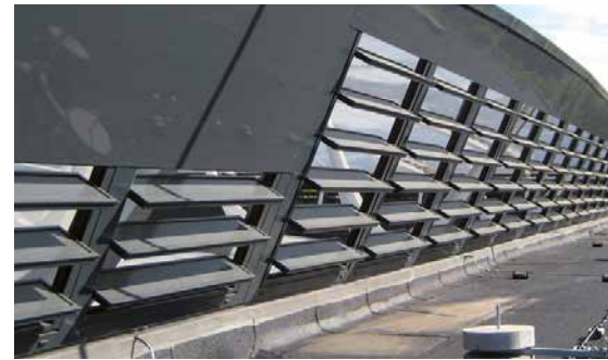
Kettler Kolleg, Mainz: Ausführung mit 40 mm Panelfüllung in Fensterfarbe. Besonderheit: Einbaulage nach außen geneigt
