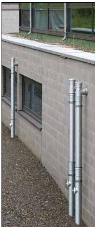
LORO-X Regenstand- und Regenfallrohre mit einer LORO-X Attikaentwässerung
