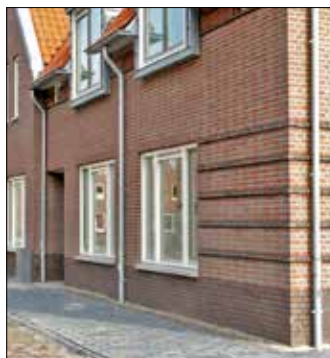
LORO-X Regenstandrohre im Wohnungsbau
