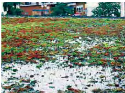
Ein extremes Beispiel – aber auch geringere Pfützenhöhen sind bereits kritisch!
