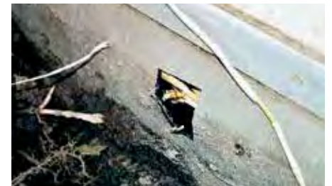
Bereits durch die Abdichtung gewachsene Bambusrhizome
