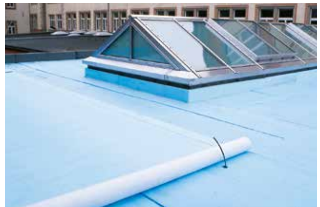
Abb. 28: Lose Verlegung der Trennlage
