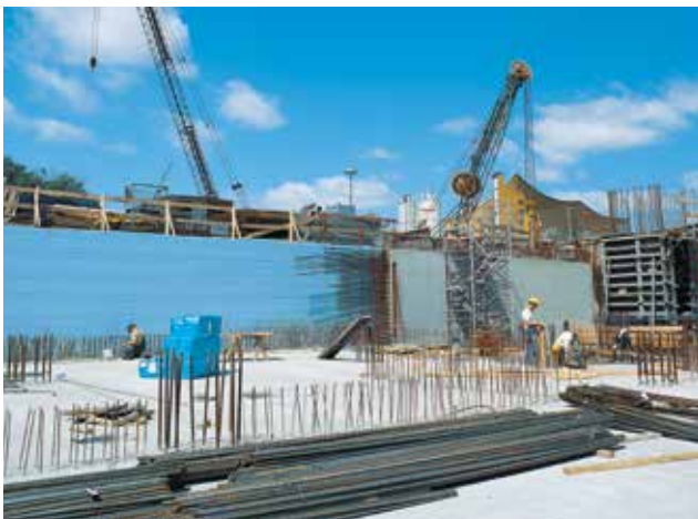
Abb. 29: Die an der Spundwand befestigten Perimeterdämmplatten werden beim Betonieren der Kelleraußenwand als verlorene Schalung genutzt
