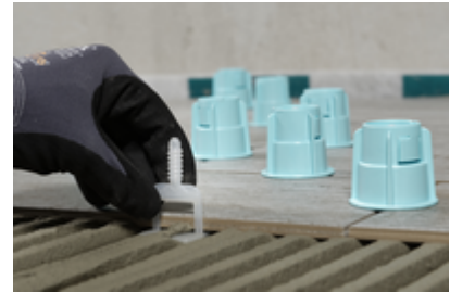
15. Zur Vermeidung von Überzähnen an der Belagsoberseite kann das ARDEX Nivelliersystem eingesetzt werden.
