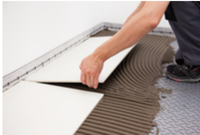
14. Der Belag wird voll satt in das Kleberbett gebettet. Insbesondere bei großformatigen Fliesen ist eine Verlegung im kombinierten Verfahren zweckmäßig. Es ist mit einer längeren Abbindezeit des Fliesenklebers zu rechnen.
