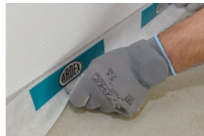
3. Entlang aufgehender Bauteile und Belagsdurchdringungen ist der ARDEX TP 50 Randdämmstreifen, zu stellen.
