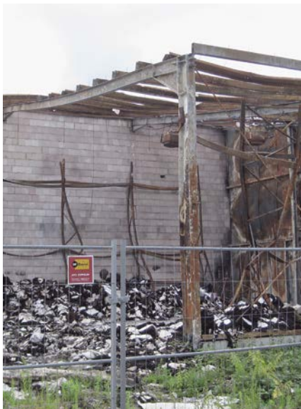
Bild 10 Durch Brand verformte Stahlkonstruktion vor unversehrter Kalksandsteinwand
