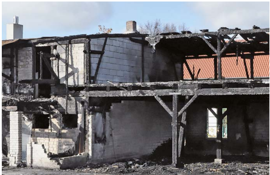
Bild 11 Durch einen Brand verkohlte Holzkonstruktion vor einer unversehrten Kalksandsteinwand; wegen ungetrennten Dachanschlüssen wurde das Feuer weitergeleitet.
