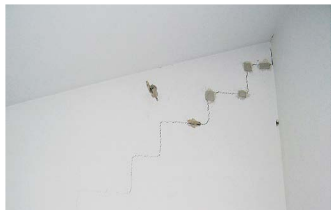
Bild 13 Rissbildung durch Verkürzung eines Stahlbetongurts
