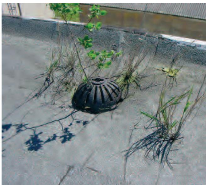
Durchwurzelung durch Rhizome
