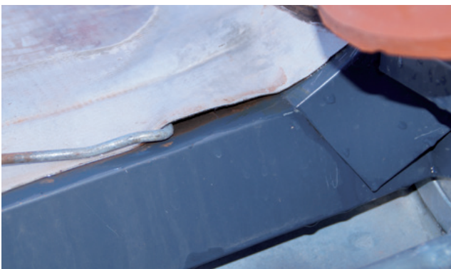
Bei nicht fachgerechtem Anschluss – hier Materialwechsel mit Nahtverklebung – sind Schäden vorprogrammiert.
