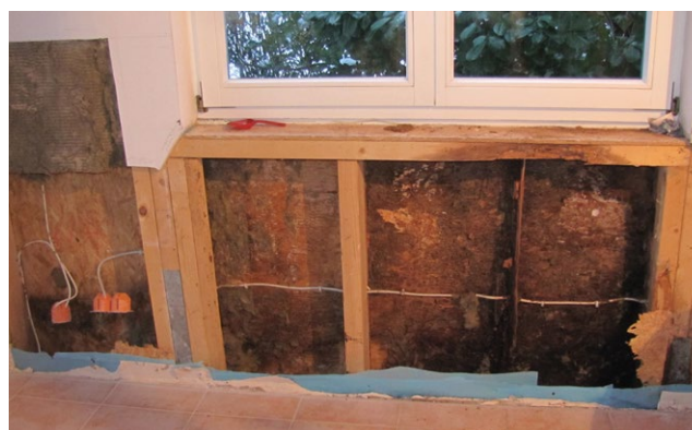
Am falschen Ende gespart: Die Sanierungskosten übersteigen die Kosten einer fachgerechten Sockelabdichtung um ein Vielfaches.
