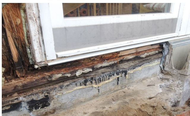
Der missglückte Versuch einer Sockelabdichtung im Gründungsbereich und die fatalen Folgen.
