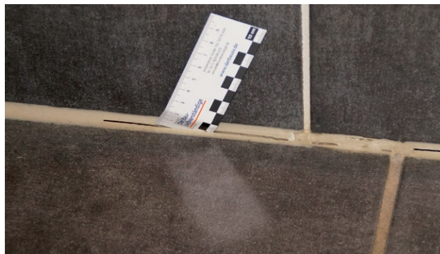
Undichte, abgerissene Silikonfugen sind oftmals die Ursache für einen Feuchteintrag in die Konstruktion.
