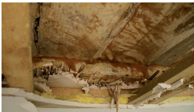
Die Holzbalkendecke ist durchfeuchtet und durch einen pflanzlichen Holzschädling befallen. Die Standsicherheit ist nicht mehr gegeben.
