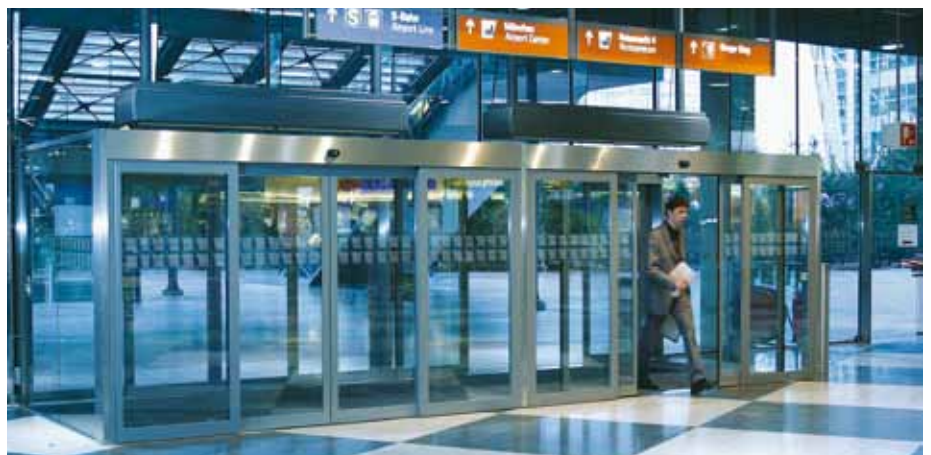
Rauchschutztüren, Eingangsbereich, MUC
