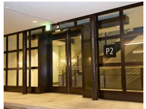
Automatische Brandschutztür, Parkhaus
