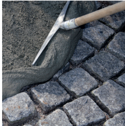
Beim Schlämmverfahren lässt sich PCI Pavifix CEM mit einem Gummischieber leicht in die Fugen einbringen.
