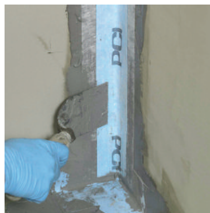
Die Dichtbänder PCI Pecitape in die Eckverbindung eindichten.
