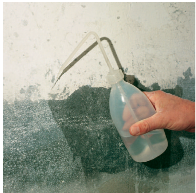
Die Wand konnte ausreichend gut entölt werden. Das hier zur Demonstration aufgesprühte Wasser dringt etwas ein und perlt nicht sofort ab.
