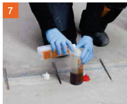
7 Sind die Nuten so weit vorbereitet, werden die beiden Komponenten von PCI Apogel® SH zusammengeschüttet ...
