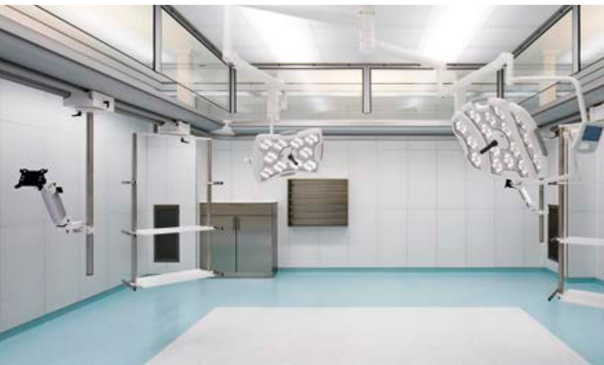
Spezialglasuren für den Einsatz von Lasern in OPs Krankenhaus der Barmherzigen Brüder, München, Deutschland / Architekt: Generalplanung Architekt Szauer, Eisenstadt, Österreich / Foto: Monika Custodis
