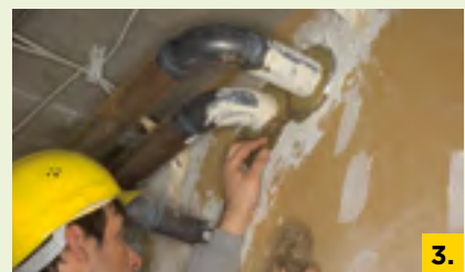
3. Verschließen Sie unregelmäßige Durchbrüche gemäß Prüfzeugnis, brandsicher und rauchdicht z.B. mit Mörtel.
