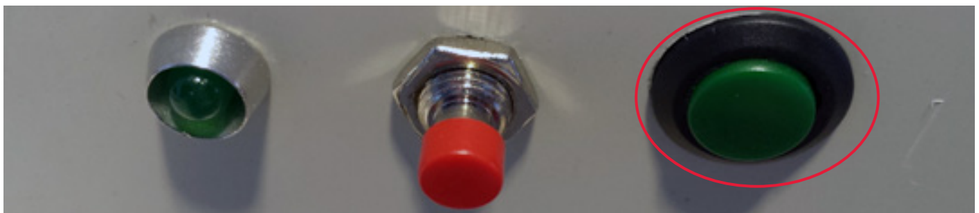
Abb. VIII: Tasten an der Außenseite des Schaltkastens
