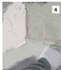
4 Das Sto-Glasfasergewebe an das Tropfkantenprofil heranführen. Gewebe anschließend in den Unterputz einbetten. Gewebestöße sollten mindestens 10 cm überlappen.
