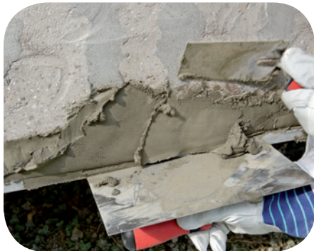
4. Auftrag des Betonersatzmörtels weber.rep R4 duo frisch in frisch auf die Haftbrücke
