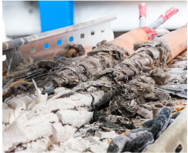
...und nach der Brandprüfung
