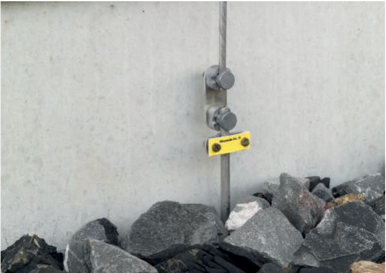
Trennstelle an einer Metallfassade
