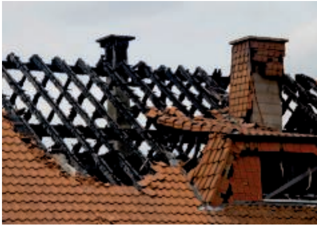
Gebäudeschäden durch direkten Blitzeinschlag
