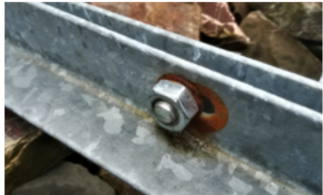
Durch eine verzinkte Unterlegscheibe und eine Edelstahlmutter ist ein ungünstiges Flächenverhältnis entstanden (Quelle: OBO Bettermann)
