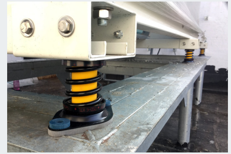
Rückkühler auf Dach installiert
