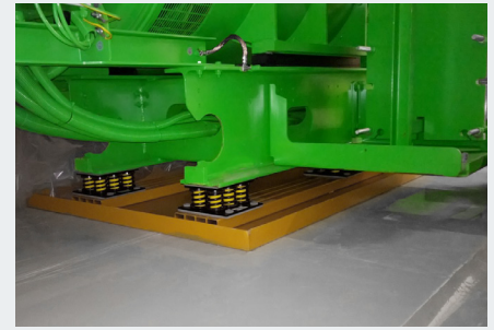
Großes Blockheizkraftwerk mit vielen Start- und Abschaltzyklen
