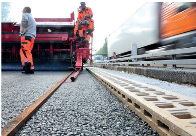
ACO DRAIN® Monoblock RD 200 V DF an der A1, Abschnitt Hamburg
