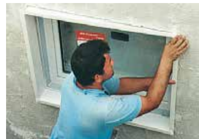
3. Zusammengesetztes Dämmungsanschlussprofil nach Abschluss der Wandbelagsarbeiten in die durch das Entfernen der Schalungsabdichtung freigewordene Nut einsetzen.
