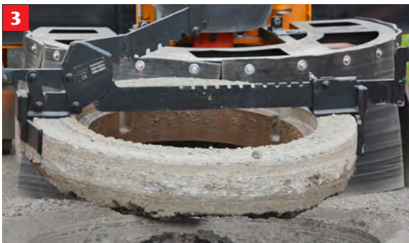
Schadhafte Abdeckung ausheben
