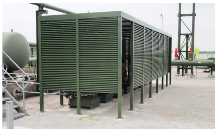
Wände verkleidet mit Storax Lamellen Typ ST-050 HF, Olivegrün pulverbeschichtet (RAL 6003)
