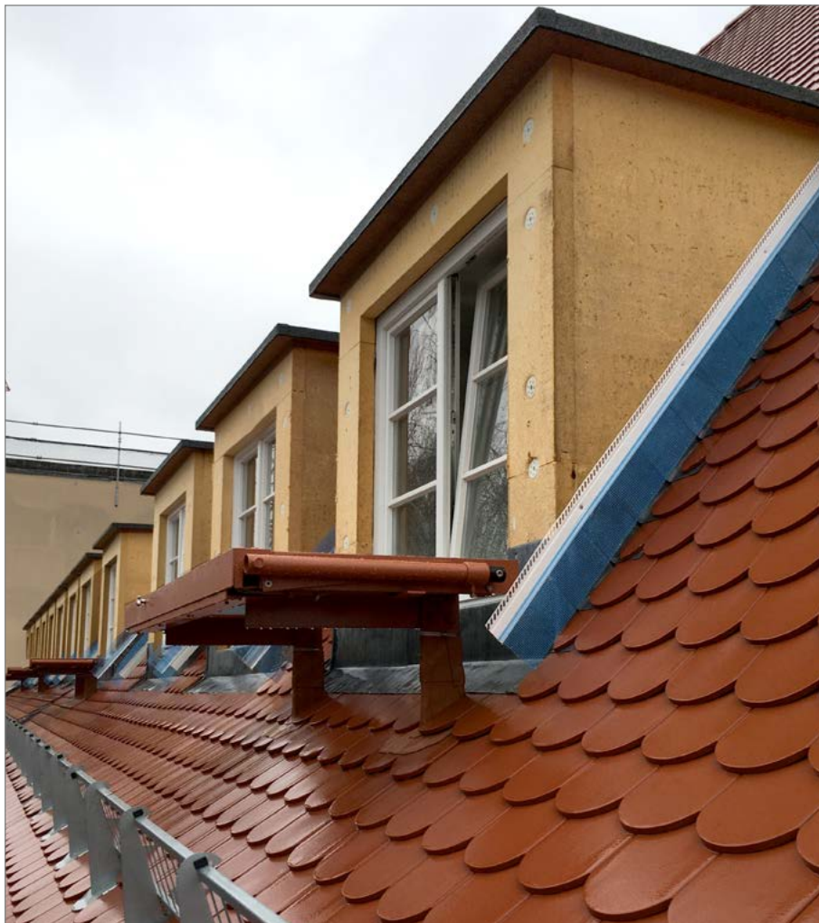
Beispiel einer Fluchweggaube mit Austrittsrost vor dem Fenster
