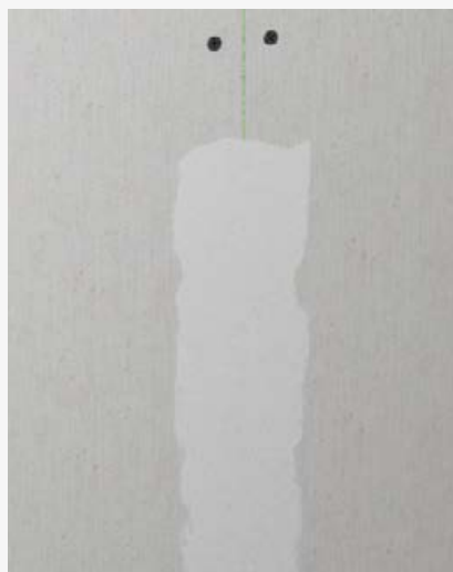
Teilweise vorgenommene Fugenspachtelung
