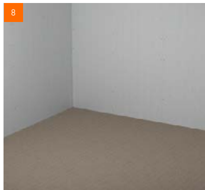
8 Nach dem selben Prinzip wird die gesamte Fläche mit Gebundener Schüttung T versehen
