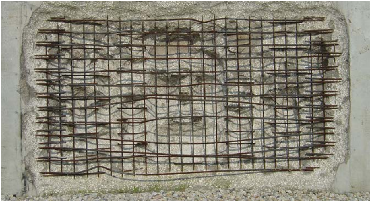
Bei schneller Erwärmung und hoher Temperaturbeanspruchung kann es zu erheblichen Schäden an den Betonbauteilen kommen.
