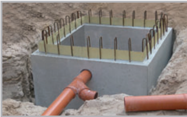
PILO-Pumpensumpf mit angeschlossenem Zulauf.
