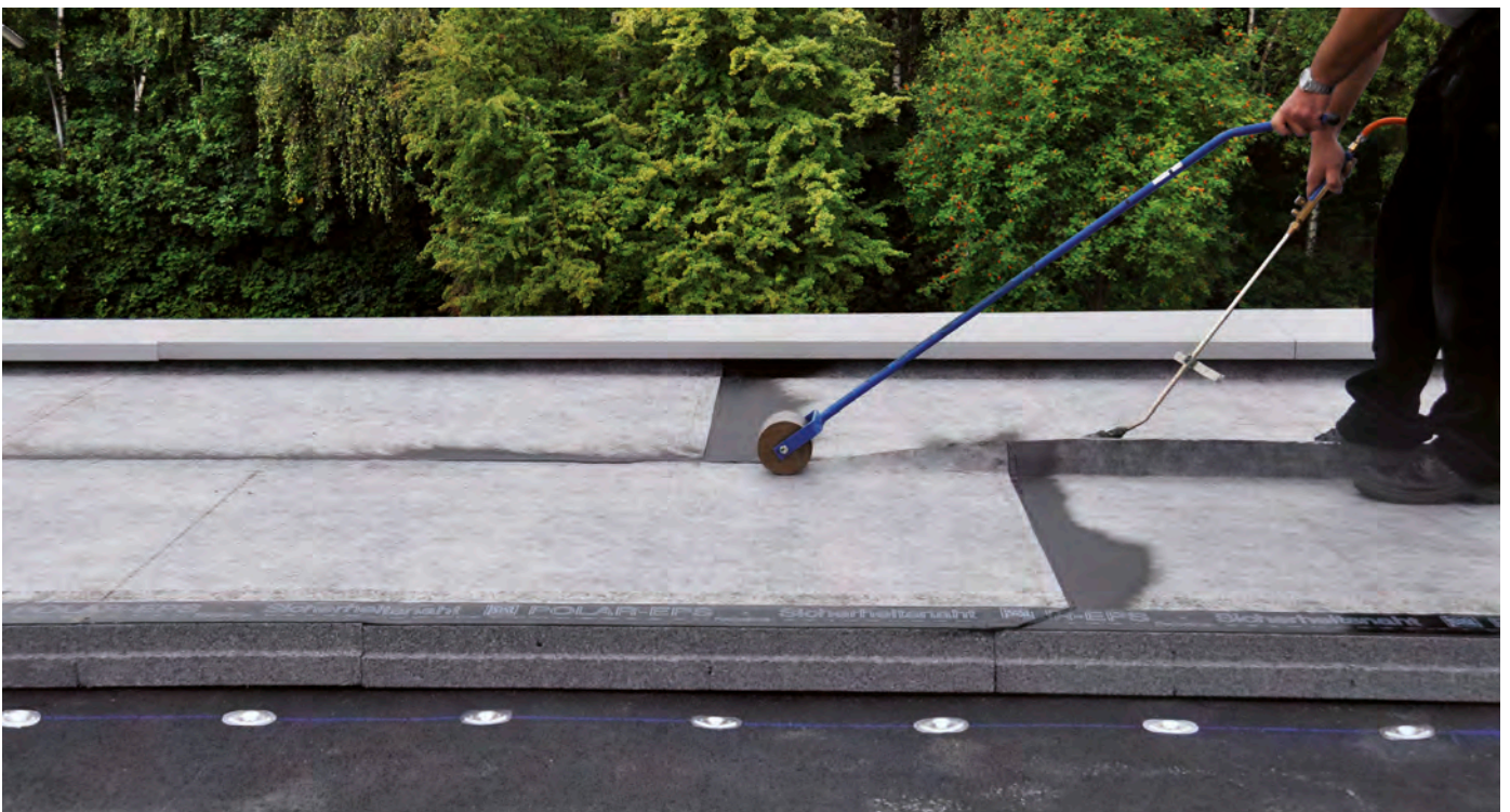
Die Längsnähte der Nahtüberdeckung der Sicherheitsdämmbahn werden nach dem Schließen des selbstklebenden Schutzstreifens mit dem Icopal-Handbrenner und der Icopal-Andruckrolle vollflächig verschweißt. Durch den Selbstklebestreifen in der Sicherheitsnaht wird ein Verbrennen des Polystyrol-Hartschaums ausgeschlossen
