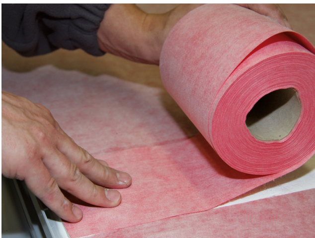
Anschließend wird Sopro AEB® Dichtband in das Kleberbett eingelegt und der Stoßbereich überklebt.
