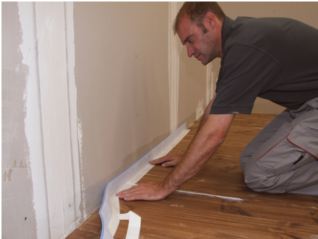
Um ein Hinterlaufen der Spachtelmasse zu verhindern, ist der selbstklebende Sopro RandDämmStreifen aufzustellen.
