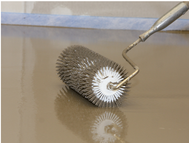
Zur Entlüftung eingeschlossener Luftblasen kann die Spachtelmasse mit einer Stachelwalze durchgerollt werden.
