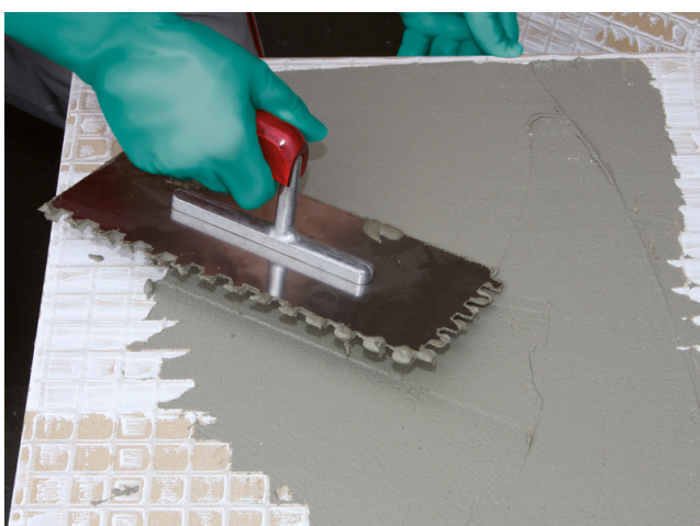
Die Anwendung des Buttering-Floating Verfahrens ist von Format und Rückseitenbeschaffenheit der Fliese abhängig und dient der weitgehend vollflächigen Verklebung des Belages.
